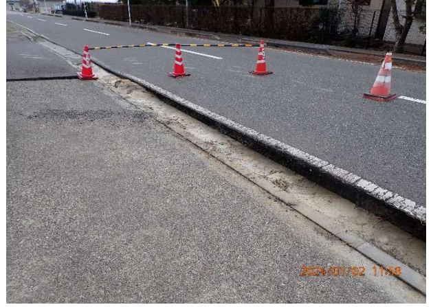
車道と舗装の隙間から砂が流出
