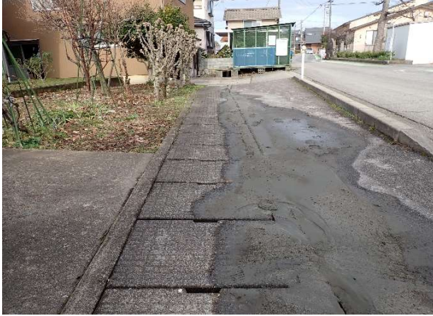
排水路の隙間から土砂が噴出
