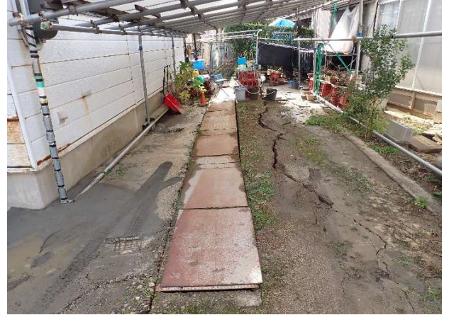
排水路脇が地割れ
