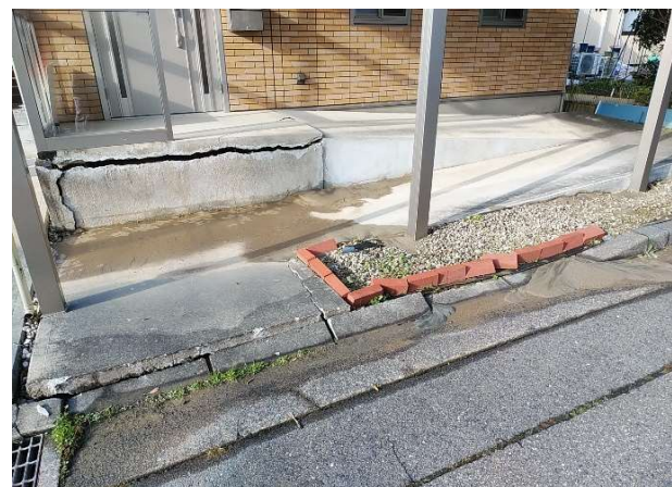
民家玄関ステップ破損
