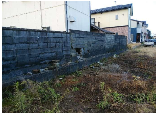
排水路溝畔脇のブロック塀破損
