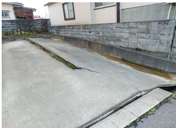
周辺民家駐車場 液状化現象により隆起
