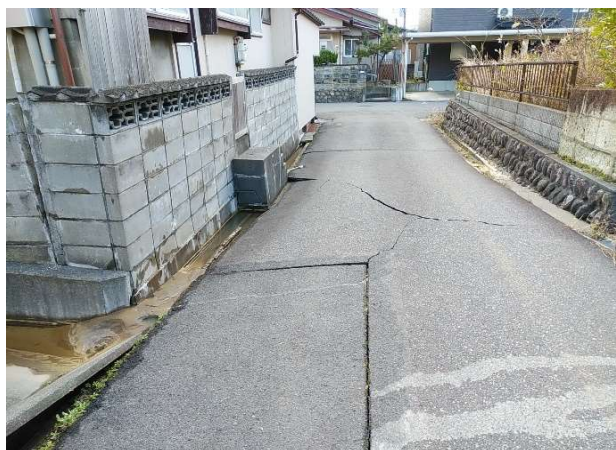
私道舗装ひび割れ
