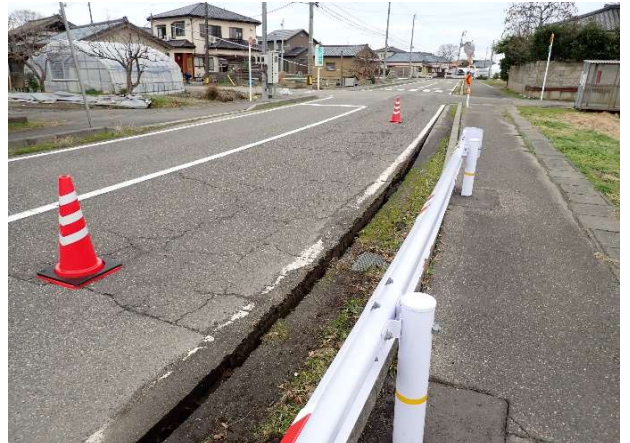
車道部と歩道部乖離
