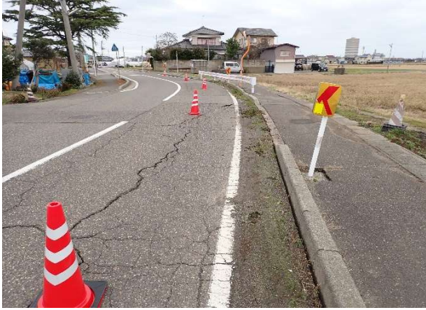
地震による舗装ひび割れ
