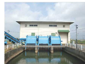
① 取水源となる舞潟揚水機場
